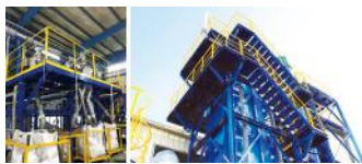
リチウムイオン二次電池リサイクル工場
