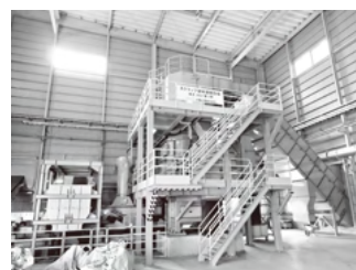
スクラップ破碎選別設備
