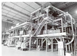
ダスト選別破碎設備
