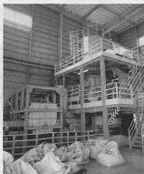
新設したスクラップ破砕設備
