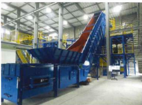
投入エプロンコンベア
